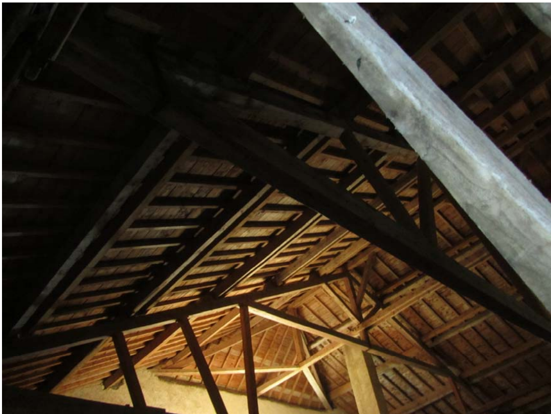
La poutraison presque neuve laisse penser qu'elle a été refaite en même temps que la couverture.
